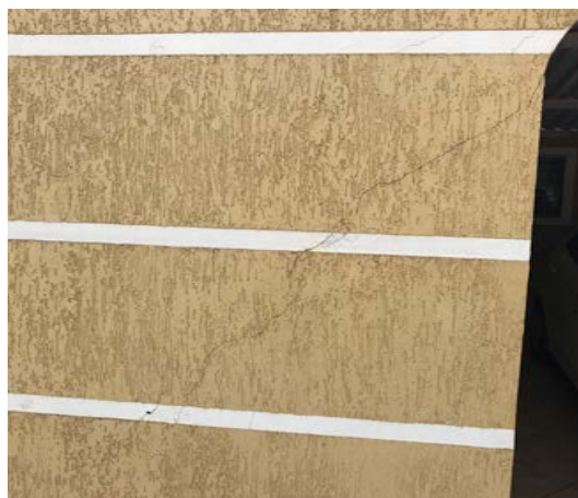
Figura 10 – Trinca diagonal na fachada da edificação (Edificação 2) Fonte: Autoria própria (2019).
