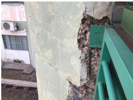
Figura 15 – Armadura exposta (Edificação 18) Fonte: Autoria própria (2019).
