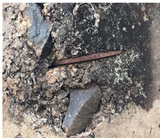
Figura 20 – Armadura oxidada (Edificação 9) Fonte: Autoria própria (2019).
