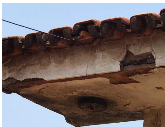
Figura 13 – Desagregação do concreto (Edificação 1) Fonte: Autoria própria (2019).
