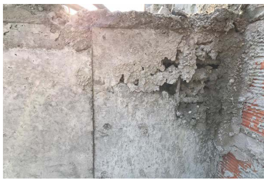
Figura 17 – Nicho de concretagem e exposição das armaduras (Edificação 4) Fonte: Autoria própria (2019).
