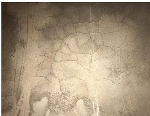
Figura 11 – Fissuras mapeadas em argamassa de revestimento (Edificação 13) Fonte: Autoria própria (2019).
