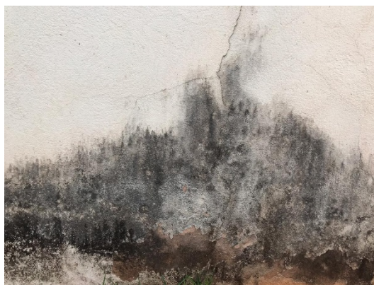
Figura 07 – Mancha escura de bolor (Edificação 6)
