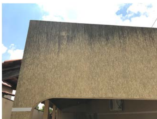
Figura 06 – Mancha escura de bolor em fachada (Edificação 2)
