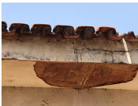
Figura 12 – Desagregação do revestimento (Edificação 1) Fonte: Autoria própria (2019).
