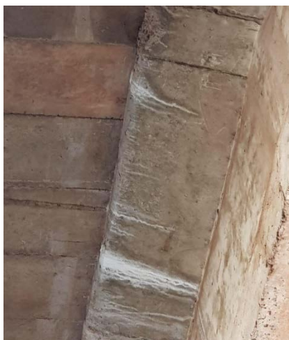
Figura 08 – Manchas de eflorescência (Edificação 25) Fonte: Autoria própria (2019).
