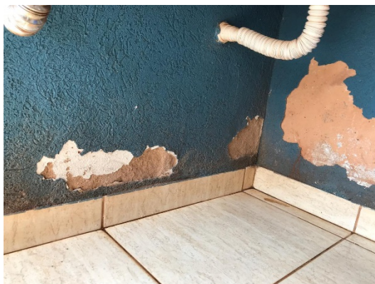
Figura 05 – Destacamento da pintura (Edificação 3) Fonte: Autoria própria (2019).
