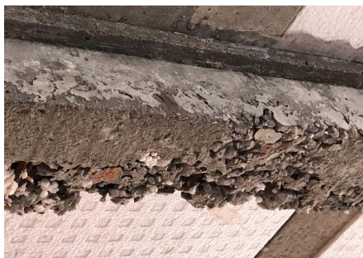
Figura 18 – Segregação dos materiais em viga de concreto armado (Edificação 7) Fonte: Autoria própria (2019).
