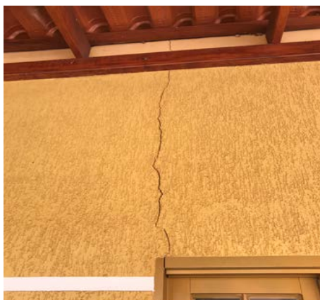
Figura 09 – Rachadura em parede de alvenaria acima do vão da porta (Edificação 2) Fonte: Autoria própria (2019).
