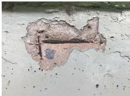
Figura 16 – Armadura exposta (Edificação 18) Fonte: Autoria própria (2019).
