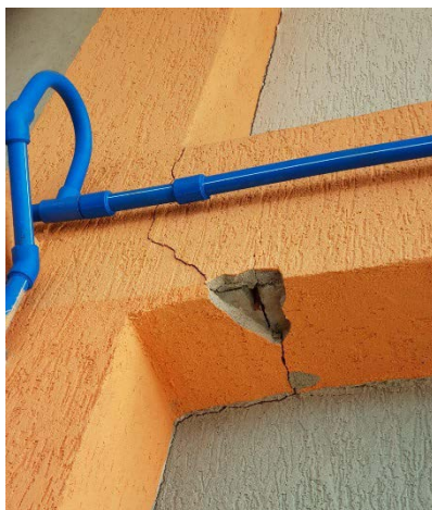
Figura 14 – Trincas seguidas de desagregação do concreto (Edificação 21) Fonte: Autoria própria (2019).
